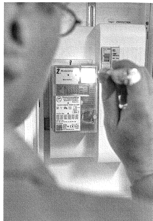
Smarte Zähler machen komplette Stromsperrungen überflüssig.
