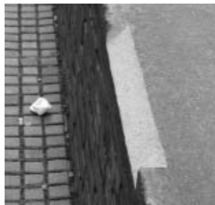
Abgefräste Kanten: Auf dem Roncalliplatz wurden schon Fakten geschaffen
